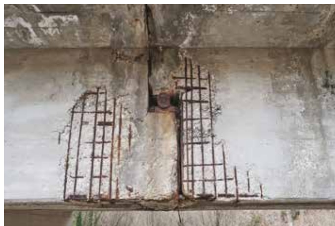
7. La corrosione di una seggiola Gerber causata dalla percolazione delle acque di piattaforma
