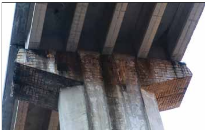
6. Un classico ammaloramento di un ponte a travata: pile e impalcato stanno bene ma i pulvini sono molto corrosi a causa della percolazione delle acque di piattaforma
