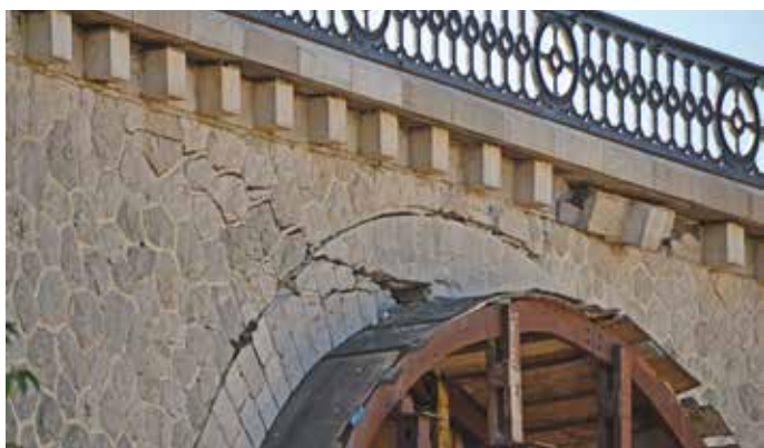
5. L'arcata crollata per schiacciamento, vista interno curva
