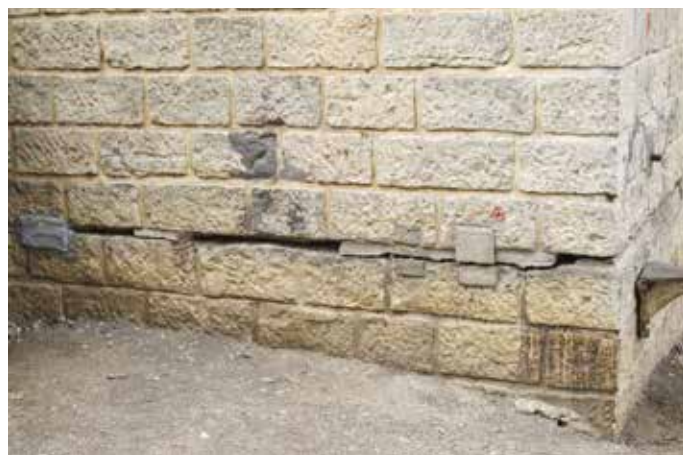
3. La fessurazione alla base delle pile
